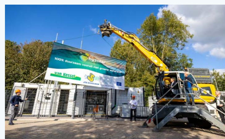
^ Elektrolyser groene waterstof Nieuwegein
