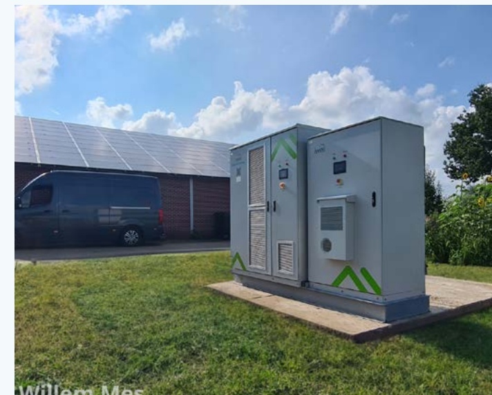
^ Projectbatterij bij zon op dak
