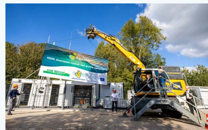
^ Elektrolyser groene waterstof Nieuwegein
